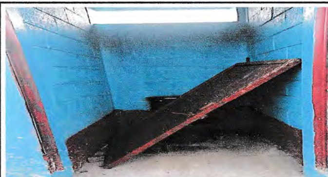
Foto 4: Puertas de sanitarios arruinadas.de 210 cm por 89 cm. De ancho
