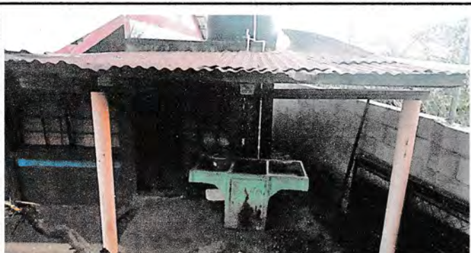
Foto 3: Lámina de cocina deteriorada de 3 metros de ancho por 5 largo
