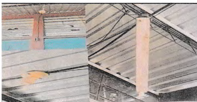
Foto 6: Sustrucción de focos por el mal estado, es necesario colocación de focos ahorradores y asegurar las plafoneras .
