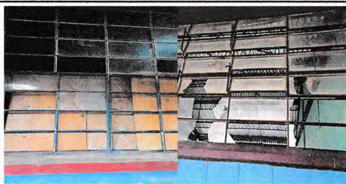
Foto 1: Ventanas el vidrio se encuentra quebrado en 6 aulas, las medidas de las ventanas son de 106 cm de largo por 85 cm de ancho
