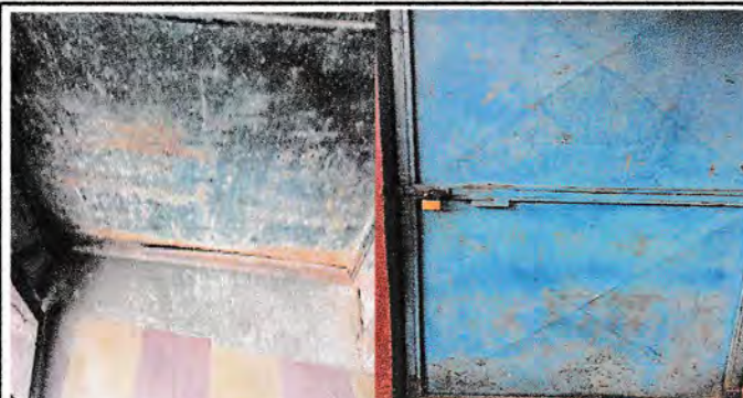
Foto 2: Puertas en mal estado se encuentran picadas por el oxido, la medidas de las puertas de 210 cm. Por 100 cm.
