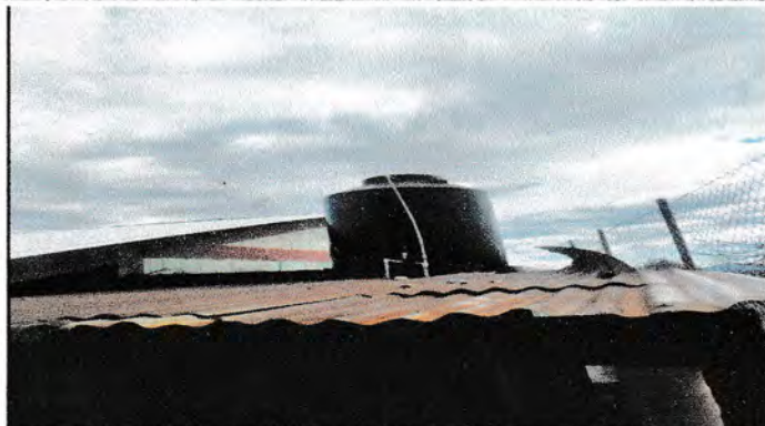
Foto 8: Sustrucción e instalción de deposito de agua que se encuentra en malas condiciones
